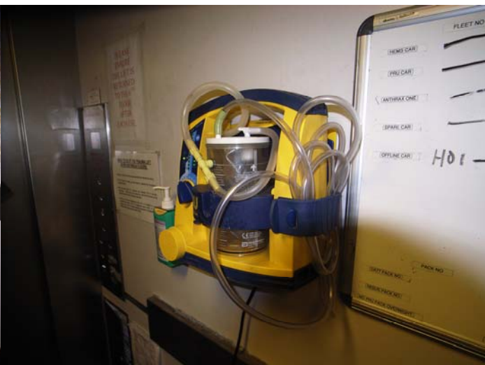
写真 6 エレベーター内の吸引器
