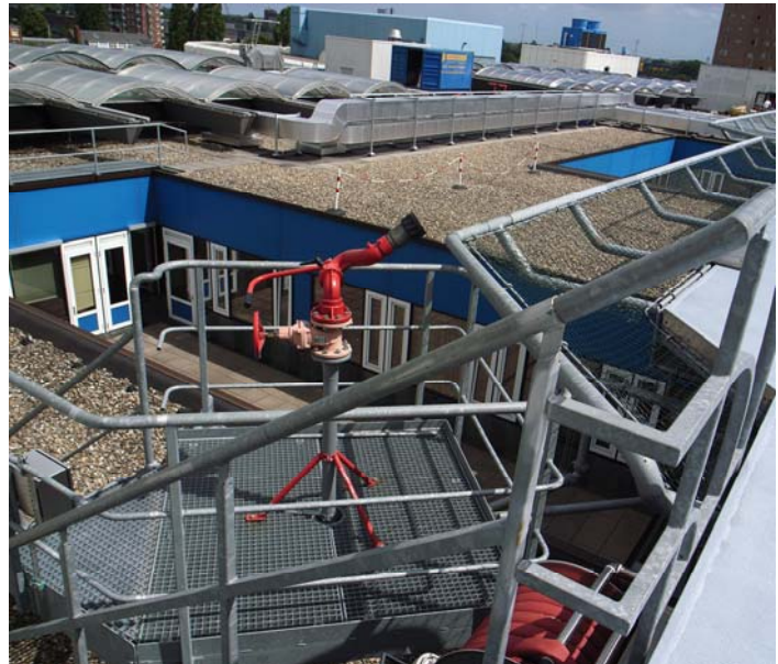
写真7 屋上ヘリポートの消火設備
